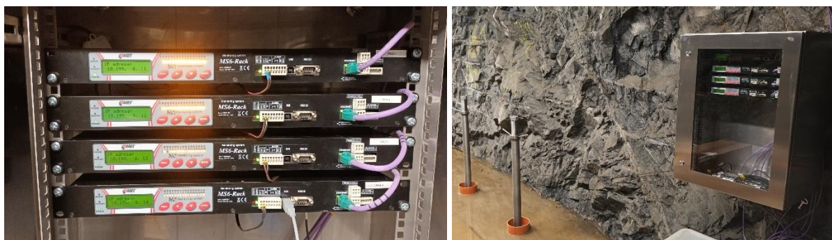
Obr. 21 Monitorovací ústředny Comet MS5, instalace ústředen v rozrážce ZK3_J
