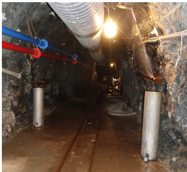
Obr. 133 Osazení přítoku BK32 měrnými válci a žlabem
