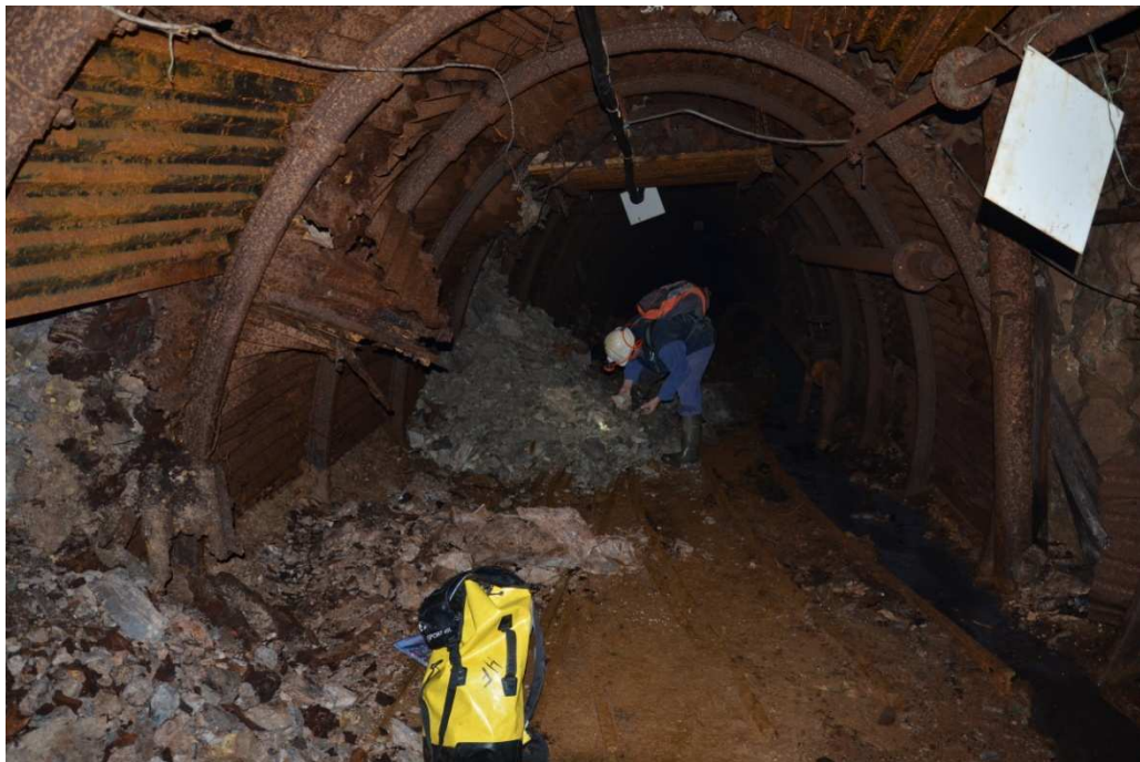
Obr. 227 Důl Rožná, 12. patro, chodba PŠ4-125 - výval zóny R4 ze západní stěny chodby
