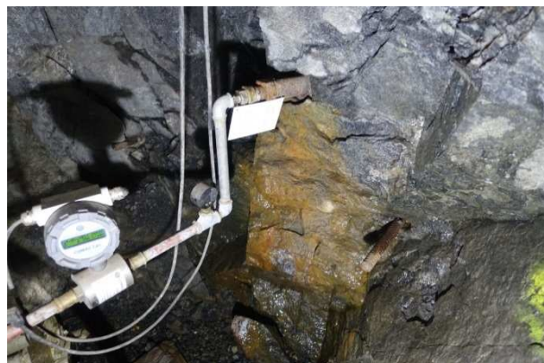
Obr. 118 BK27 Přítok z vrtu S-2 po instalaci průtokoměru. Na stěně napravo dochází k průsaku na nově otevřených puklinách
