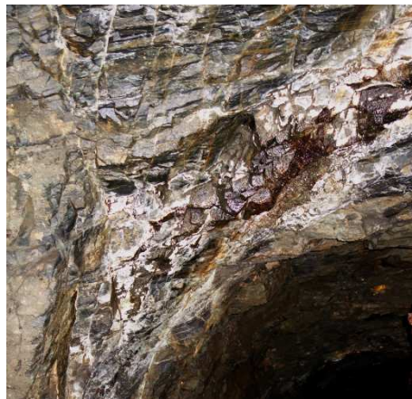
Obr. 123 BR25 drobné průsaky ve formě kapek z puklinového systému křížícího chodbu (140/75), 14. patro, Z-XIV, jáma R3.
