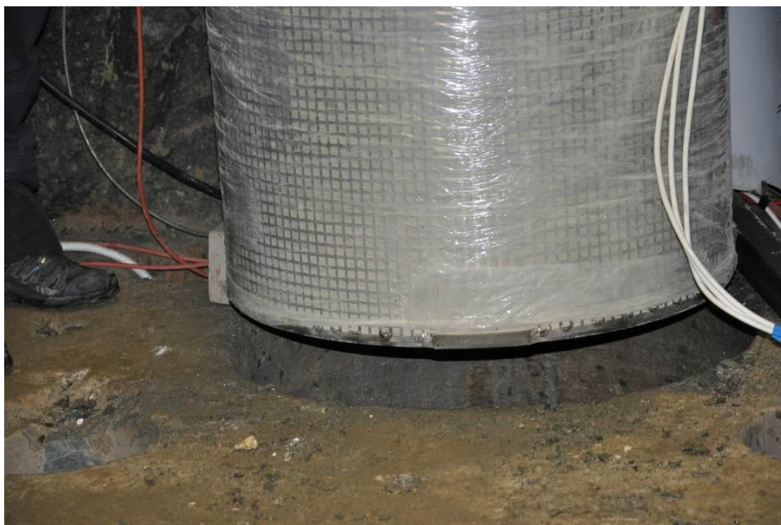
Obr. 30 - Dno modelu nad úložným velkoprofilovým vrtem o průměru 750 mm a hloubce 2800 mm před spuštěním.
