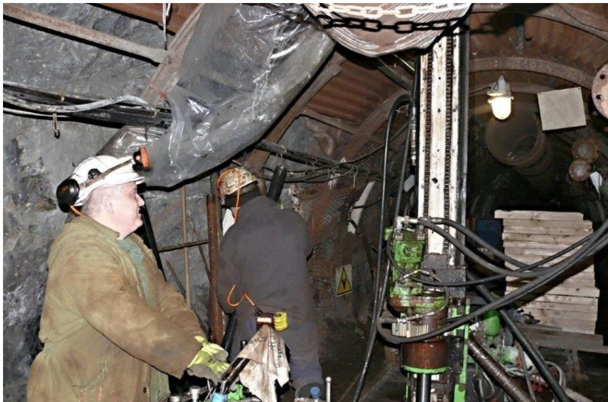
Obr. 16 Vrtání geotechnického vrtu BGS24 V(D) o průměru 76 mm do počvy geotechnické stanice na překopu Z 3 -XXIV. 24. patro jámy R-7S ložiska Rožná. 11. 3. 2019
