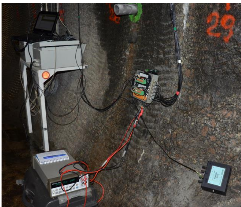
Obr. 69 Kontrola aparatury uvnitř bedřichovského tunelu.
