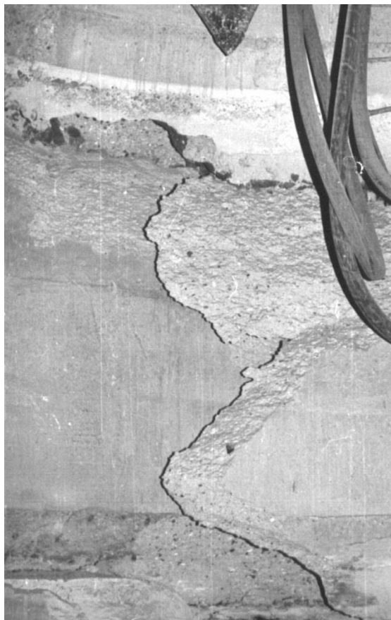
Obr. 29 Pukliny na stěně betonového ostění šachty
