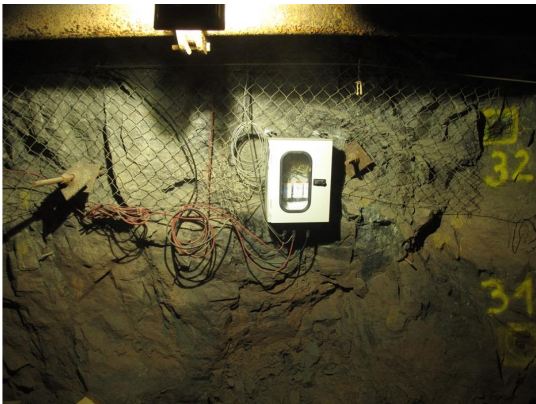
Obr. 4 Podružný koncentrátor dat pro připojení tenzometrických měřicích svorníků v lokalitě konvergenční stanice KS2
