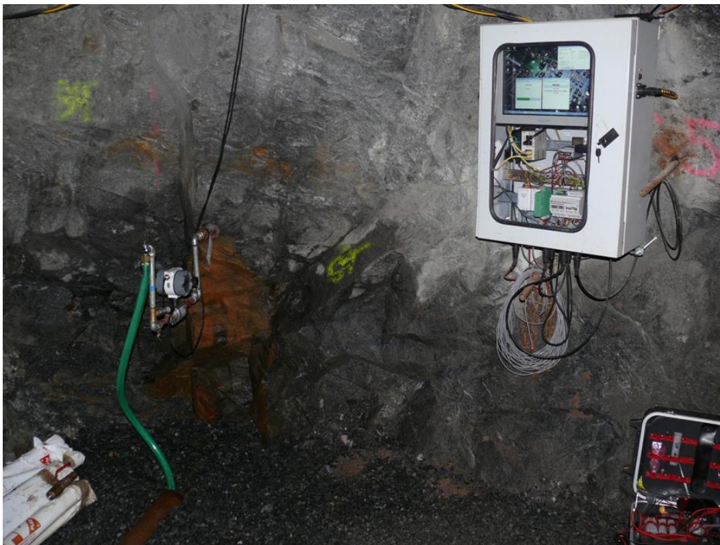
Obr. 2 Hlavní řídicí rozvaděč umístěný ve Vrk 1, vlevo je vidět do DMS připojené zařízení monitorující hydraulický režim vrtu
