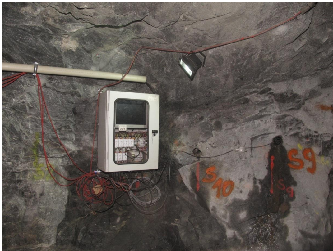
Obr. 3 Záložní hlavní rozvaděč s řídicím PC umístěný ve výklenku BZ1-XII v oblasti monitorovacích vrtů S9-S13
