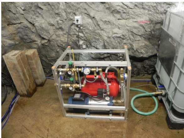
Obr. 5 – Čerpadlo a regulace sytícího systému
