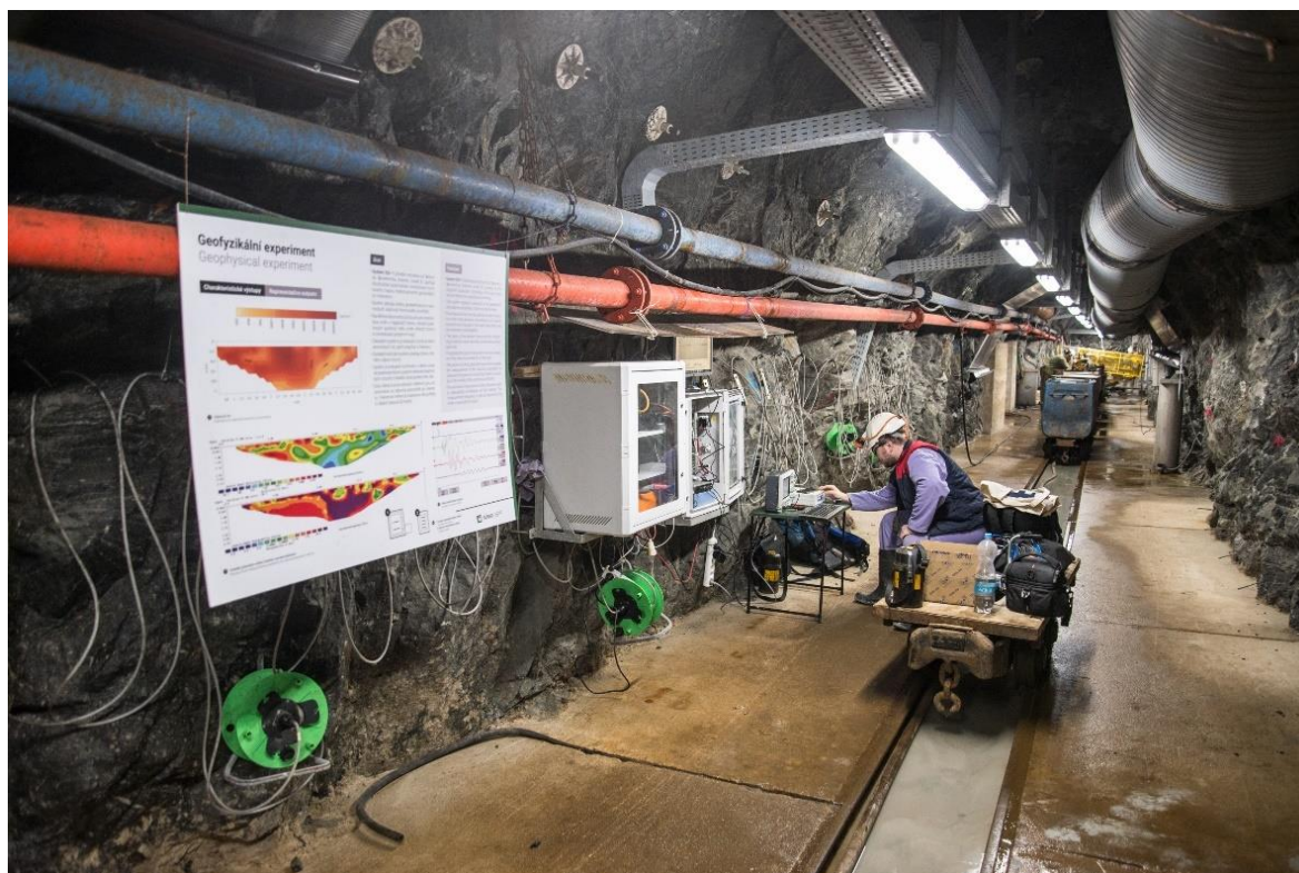
Obr. 16: Systém SGI 1 na pracovišti v PVP Bukov při pravidelné kontrole systému
