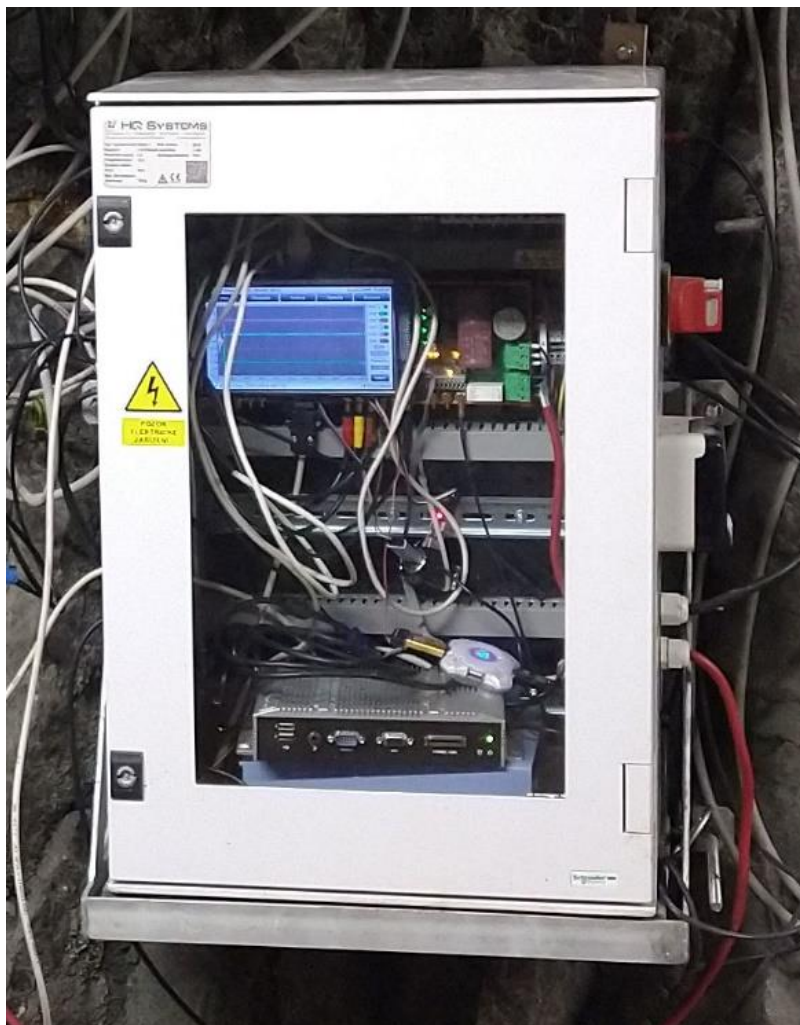
Obr. 1: Rozváděč s průmyslovým PC, řídicí elektronikou a budícím zdrojem
