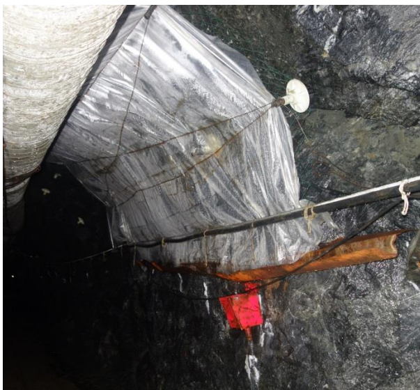
Obr. 132 Osazení přítoku BK31 sběrnou plachtou a žlabem
