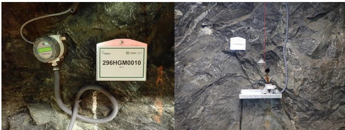
Obrázek 3 Označení měrného bodu a ukázka instalace
